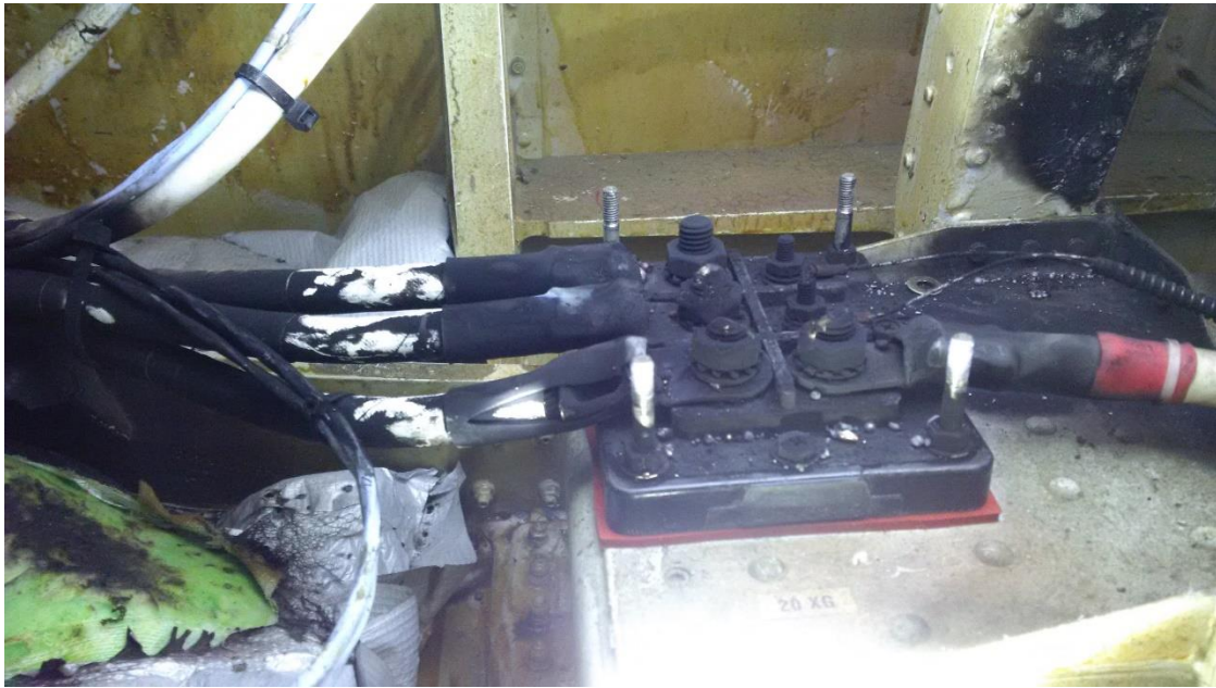
Photo 1 : Traces d'incendie. Présence de suie sur les câbles et la structure.
