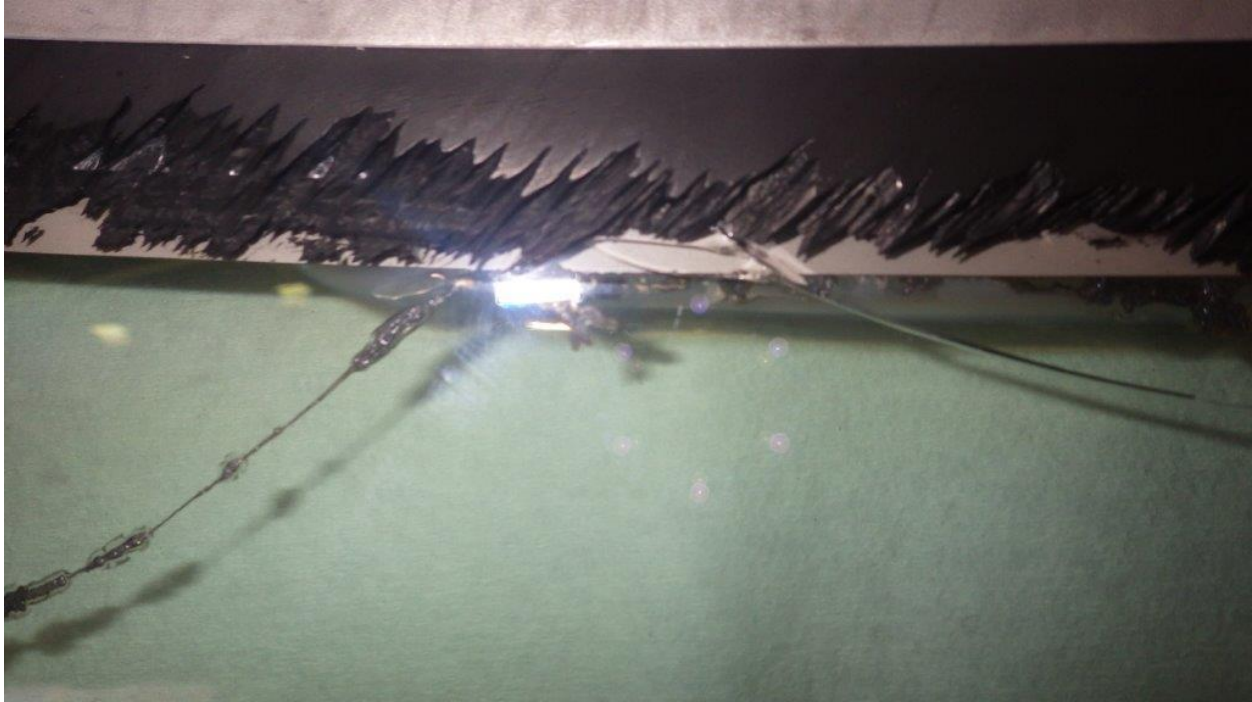
Figure 3. Plan rapproché de la zone blanchâtre et du joint d'étanchéité érodé.
